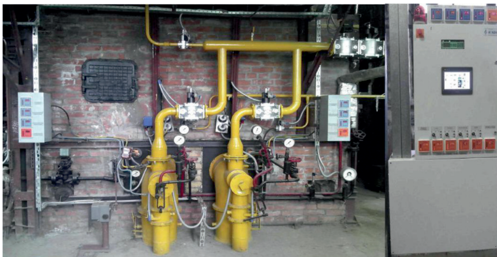
Рис. 3. Общий вид фронта котла ДКВР-10-13 с горелками ГМГ-4М, оборудованного системой «Факел-2010» (справа – щит управления системы с монитором)
